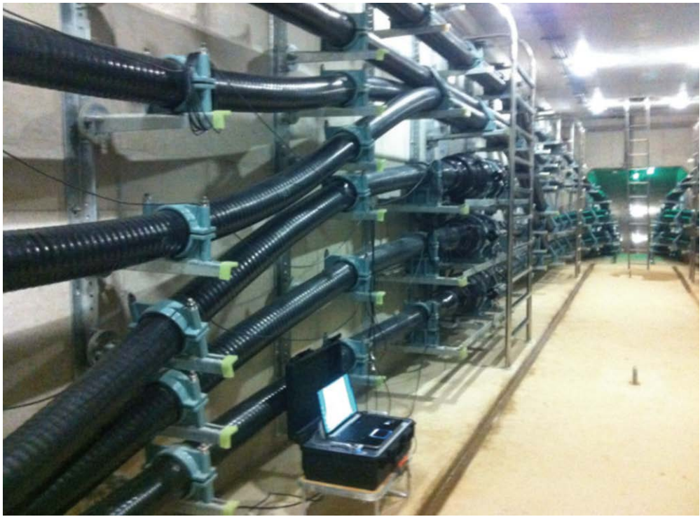
Рис. 14-а. Локальная станция мониторинга ЧР на кабельной линии
