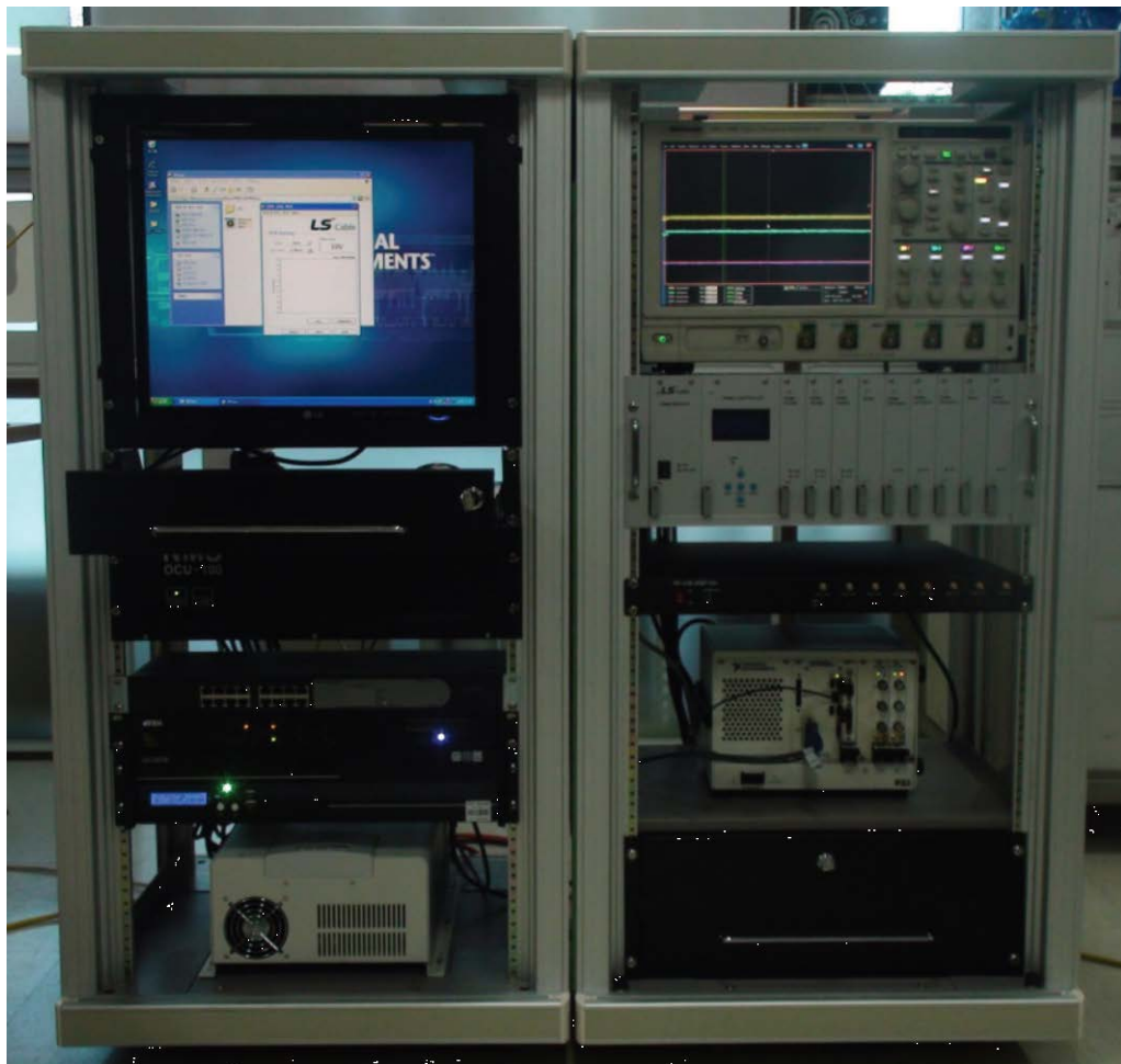
Рис. 14-б. Главная станция мониторинга ЧР на кабельной линии.
