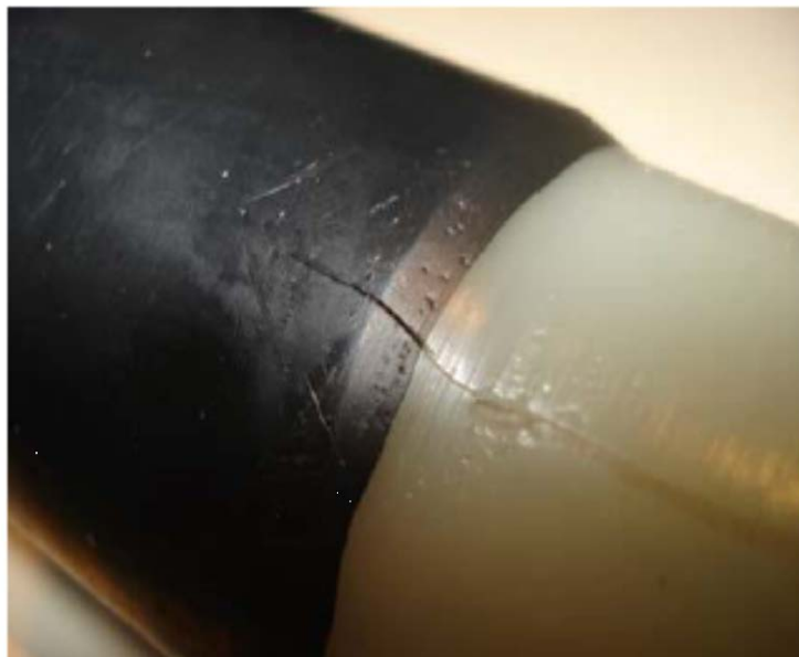
Рис. 10. Пример дефекта разделки кабеля на напряжение 36 кВ, послуживший причиной высокого уровня ЧР
