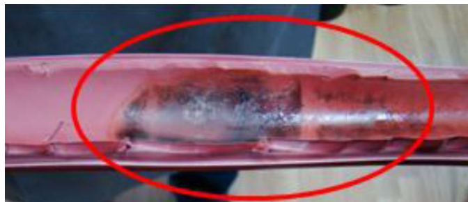
Рис. 12. Участок дефектной изоляции соединительной муфты 45 кВ
